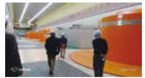
発電電動機室
